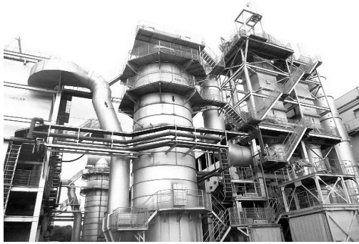
那須総合リサイクルセンターの焼却施設（ロータリーキルン炉：187.2t/日 [93.6 t / 日×2炉]）
